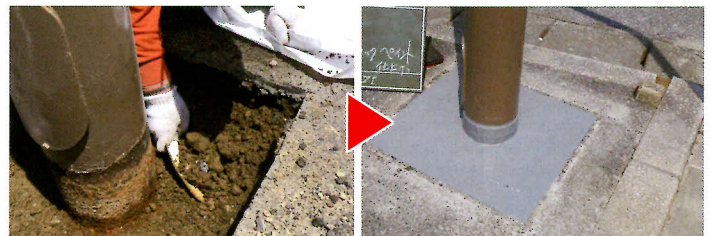
▲ 設置から期間が経過した鉄柱。雨水や犬の尿でサビ/腐食が進行。そのまま放置すれば、倒壊の危険も... ▲ サビキラーPRO RS + BAN-ZI AIDとの併用により、サビの原因となる地中への雨水やベットの尿の侵入を完全にシャットアウト。倒壊の危険を回避&耐用年数の延長も実現。
