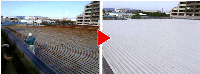
▲ 屋根全体がサビってしまった倉庫の屋上/一部では亀裂などが原因による雨漏りも見られていました。 ▲ 屋根を全面施工。防錆効果だけでなく、撥水・防水効果も得られ、雨漏りもストップ。遮熱材との併用で遮熱効果も追加可能です。
